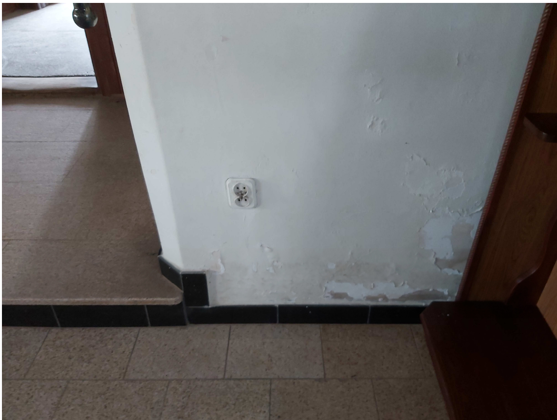
Zdjecie nr 1: Łuszczenie farby emulsyjnej na scianie wewnętrznej
