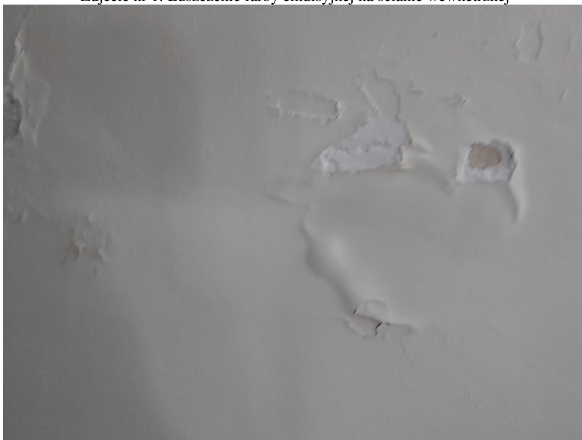
Zdjecie nr 2: Odpadające pęcherze farby na scianach wewnętrznych
